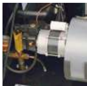
En-faset motor koblet til vifte og dieselpumpe.
